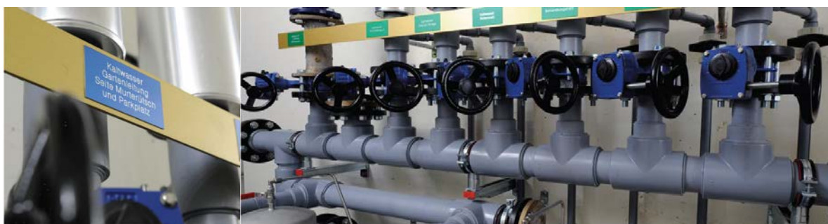
Der neue Kaltwasserverteiler in Kunststoff-INSTAFLEX
