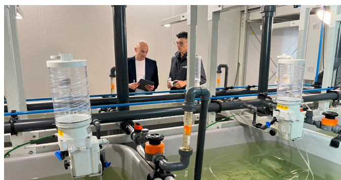
Il progetto permette di controllare una serie di parametri da remoto, rendendo l'impianto unico e inimitabile.
