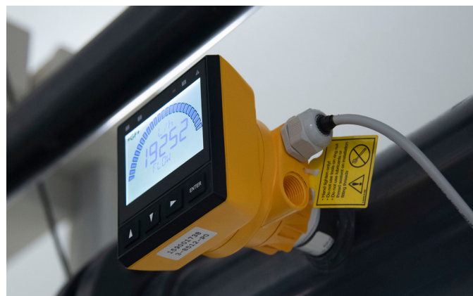
Il supporto di GF in fase di progettazione e post vendita è stato fondamentale per la realizzazione dell'impianto su misura il più sostenibile possibile.
