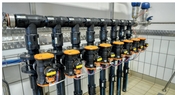
L'impianto destinato alla salamoia, dove è necessaria elevata resistenza dei materiali alla concentrazione salina e umidità.
