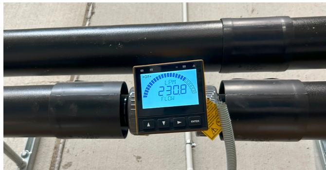
COOL-FIT 2.0 installation og 9900 transmitter med skovlhjulsmåler monteret i 3 meters højde. Alligevel kan flowet nemt aflæses når man står på gulvet.
