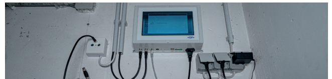
Der Hycleen Automation Master übernimmt die zentrale Steuerung von bis zu 50 Ventilen und Sensoren. Bei der Inbetriebnahme erkennt er alle Ventile und Sensoren des Systems mit ID sowie Typ. Er ordnet sie dann den passenden Applikationen zu.
