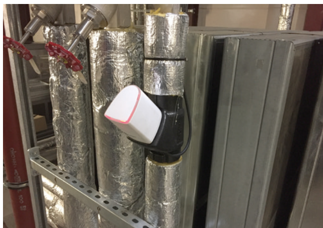
Hycleen Automation System assure une gestion fiable de l'eau potable avec des températures constantes supérieures à 55 °C et un équilibrage hydraulique.
