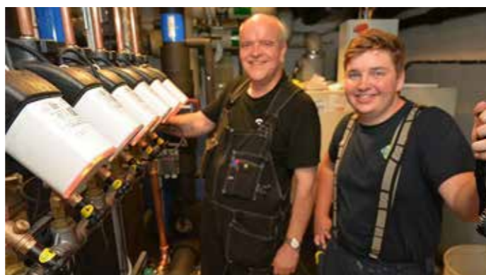
Les monteurs de sanitaires Roland Haubold et Ken Mothes de GK Pipes à Moss ont installé les deux systèmes ici dans la maison de retraite Orkerød.
