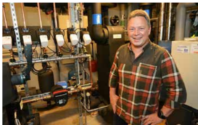
Daniel Mothes von der Kommunalen Liegenschaftsgesellschaft Moss hat die Installation des Hycleen Automation System vorangetrieben.
