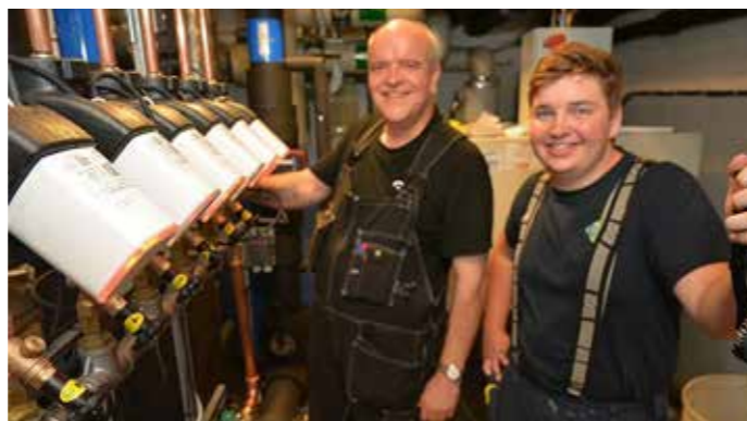
Die Sanitärinstallateure Roland Haubold und Ken Mothes von GK Pipes in Moss haben beide Anlagen hier im Pflegeheim Orkerød installiert.
