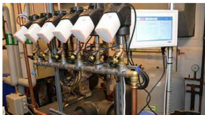
Im Pflegeheim „Orkerød Sykehjem“ wurden an jedem Warmwasserkreislauf Fühler und Ventile installiert – hier im Kontrollraum. Rechts: der Hycleen Automation Master, bedienbar per Touchscreen.
