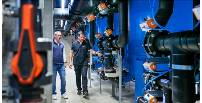
Eine breite Palette an manuellen und angetriebenen Ventillösungen von GF regelt die Filteranlagen.
