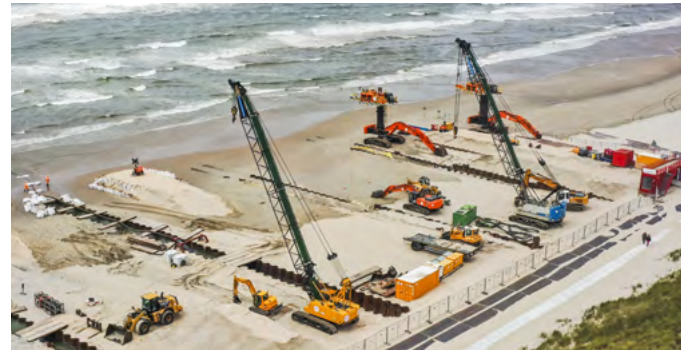
Das Grossprojekt umfasst vier Stromkabel – 220 kV mit einer Gesamtlänge von etwa 200 km jedes – die an das Hochspannungsnetz angeschlossen wurden.
