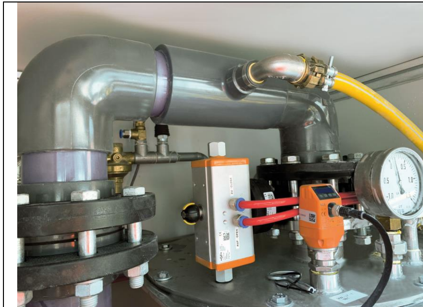
neustark Testanlage mit GF PVC Rohren und Produkten der Prozessautomatisierung
