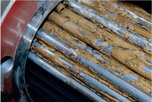
Échangeur de chaleur multi-tubes avec dépôts de calcaire
