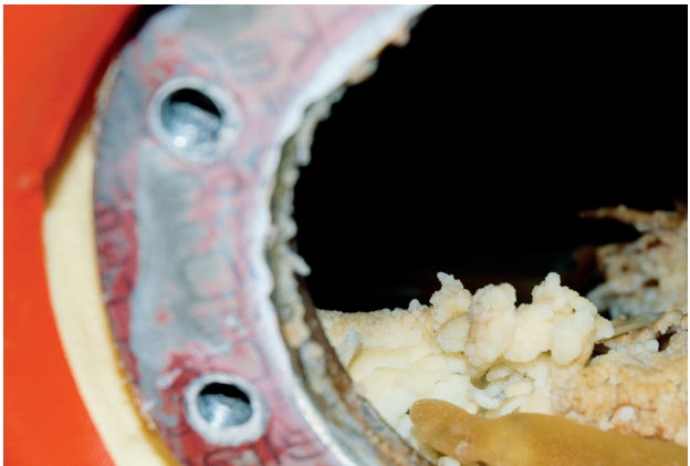
Dépôts de calcaire de 40 centimètres de hauteur dans le fond d'un ballon d'eau chaude sanitaire
