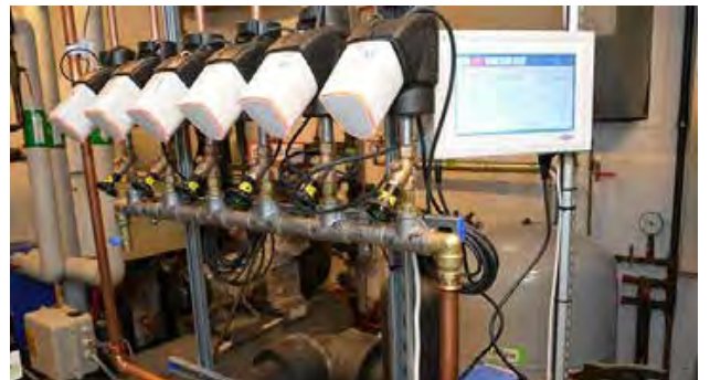
奥克罗德（Orkeröd）疗养院的每个热水管道上都安装了传感器 / 阀门，如控制室所示。右侧是系统的触摸屏。
