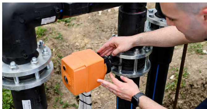
Grças às válvulas acionadas eletricamente, o sistema de irrigação tem um tempo de resposta melhor e pode ser controlado de forma centralizada.
