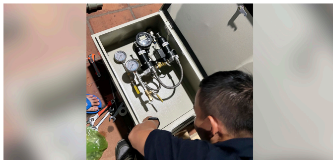
O sistema piloto foi instalado em uma caixa de painel acima do solo
