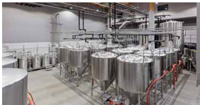
O sistema de refrigeração de tubos foi instalado até os tanques.
