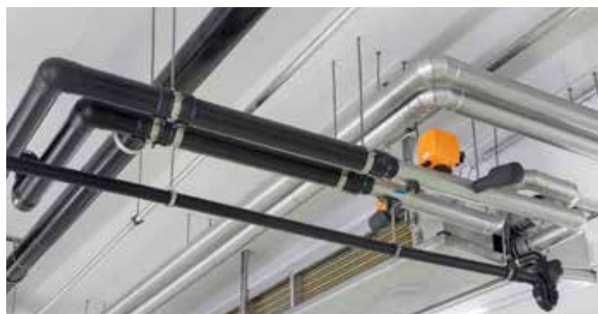
Todos os componentes do sistema de refrigeração de tubos já estão pré-isolados.
