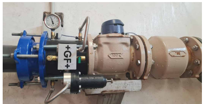
Graças à sua construção de fluxo axial, a NeoFlow também é capaz de garantir a vazão de incêndio necessária em Pecquencourt.
