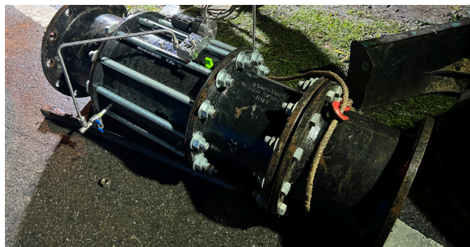
Para atender à exigência, foi instalada uma válvula DN300, que é 10 vezes mais leve que a PRV metálica anterior.
