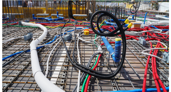
Os tubos iFIT (pretos) são instalados para o fornecimento de água potável aos apartamentos.
