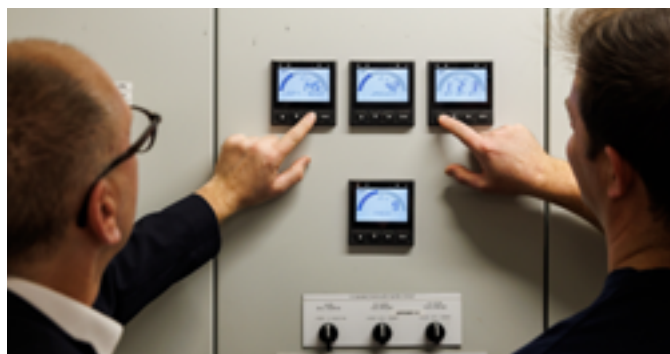
Les transmetteurs 9900 permettent au Sofitel Quiberon d'assurer un débit d'eau parfait pour les différentes installations.
