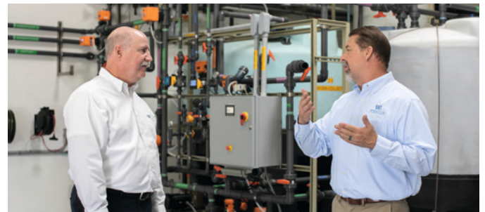
GF Piping Systems und Water Innovations arbeiten kontinuierlich daran, die Anlage weiter zu optimieren.
