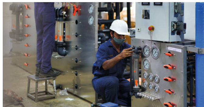
Mit den Lösungen von GF Piping Systems können die Anlagen von Rochem bis zu 200'000 Liter Wasser pro Tag aufbereiten.
